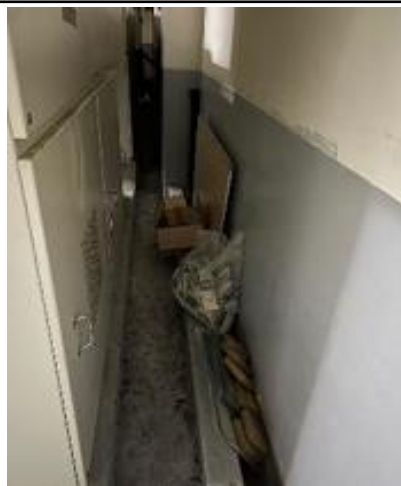
▲電氣機房內堆放無關之物品
