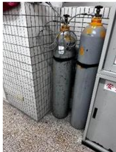
▲鋼瓶未確實固定及已逾有效期限
