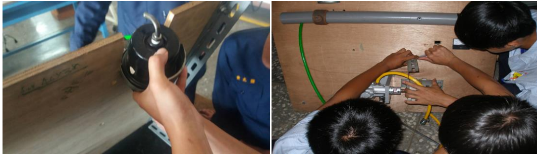
1、固定機件位置與管線位置以及氣動馬達與發電機的相對位置
