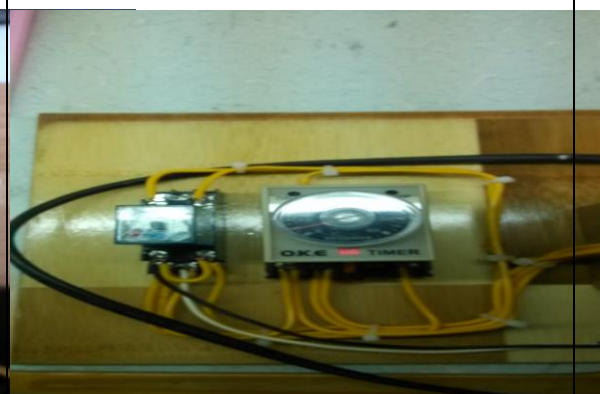
圖 14 裝上電力電驛及限時電驛
