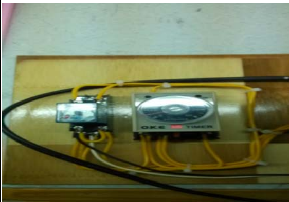
圖 16 裝上電力電驛及限時電驛
