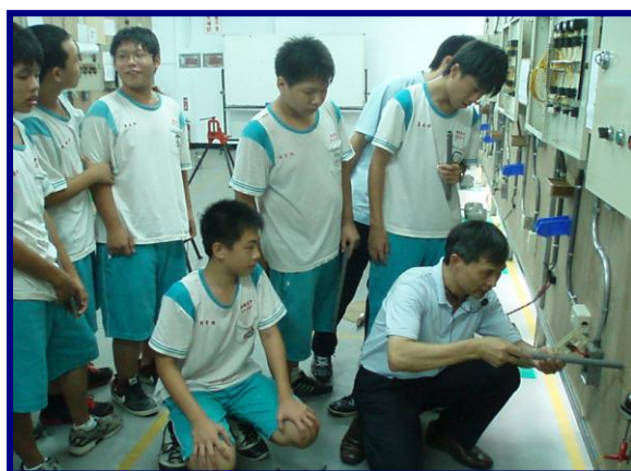
室內配線實作
