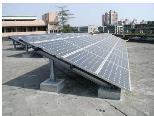
圖 9 台電電力綜合研究所太陽能發電示範系統 2
