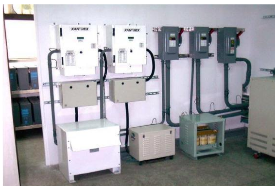
圖 8 台電電力綜合研究所太陽能發電示範系統 1
